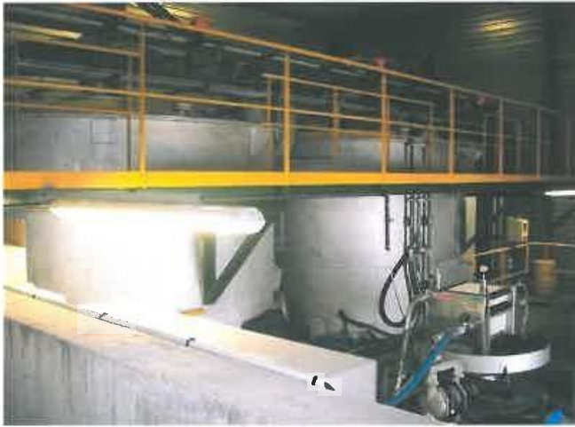
Cuves de traitements de l'eau
